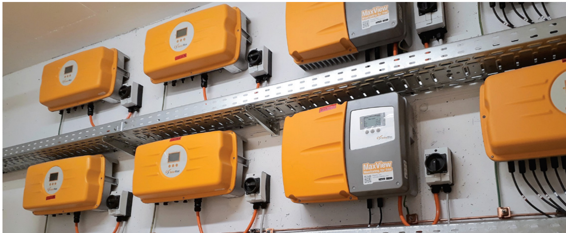
Im Keller des Energiehauses von BE Netz befinden sich die Wechselrichter der 65 kW- PV-Anlage der Gebäudehülle.
